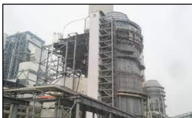
Figura 5: Instalación de gasificación por plasma en Wuhan, China.
