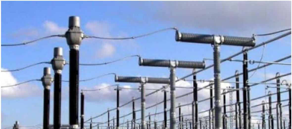
Ilustración 31: Interruptor junto con TI [20]
