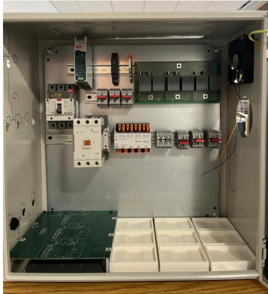
Figura 74. Disposición física de los componentes dentro de la caja, previa al cableado y sin las bobinas colocadas. Fuente: Elaboración propia (2026).
