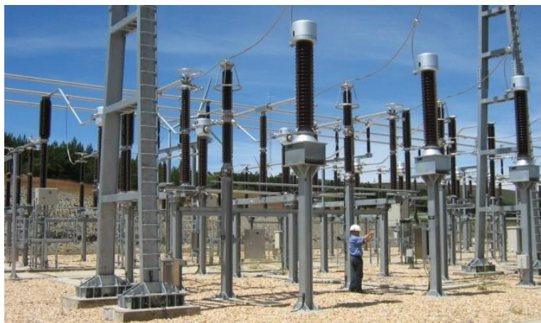
Figura 66. Subestación eléctrica Majuelo en Zamora a la intemperie de 30/66 kV [27].
