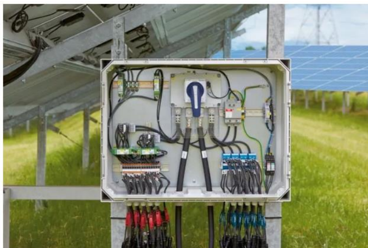
Figura 14. Caja combinadora fotovoltaica [11]
