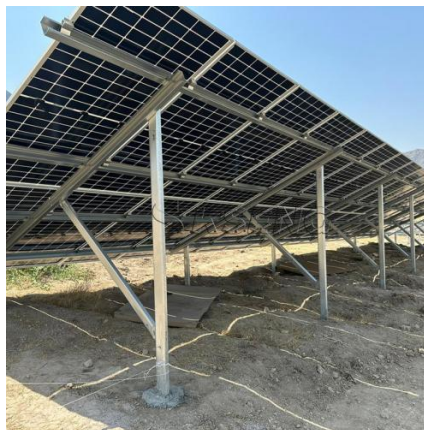
Figura 18. Módulos solares montados sobre estructura fija metálica de suelo [13]
