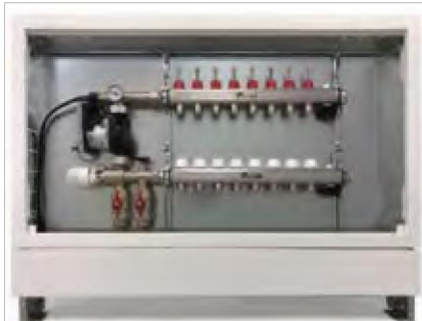
Caja con colector y grupo hidráulico compacto.
