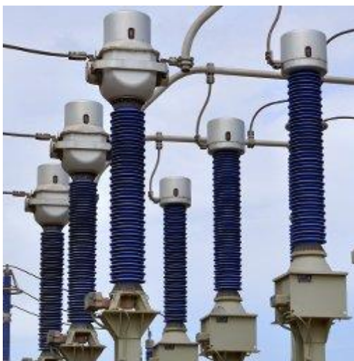
Figura 33 - Transformadores de intensidad
