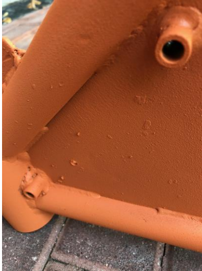
“Defecto pintura 1” imagen 46
