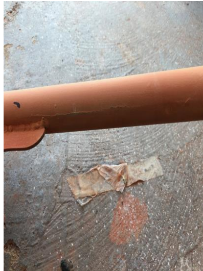
“Defecto cordón de soldadura” imagen 45
