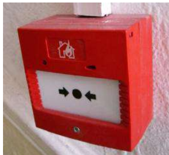
Figura 27: Sistema de alarma contra incendios
