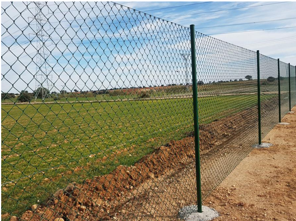
Figura 25. Ejemplo de vallado típico en plantas fotovoltaicas [27]
