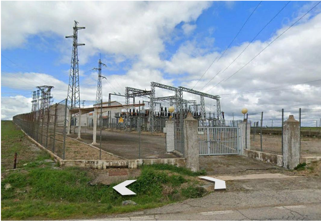
Figura 16. Subestación eléctrica (SE)-Llerena extraída de Google Earth (Streetview)
