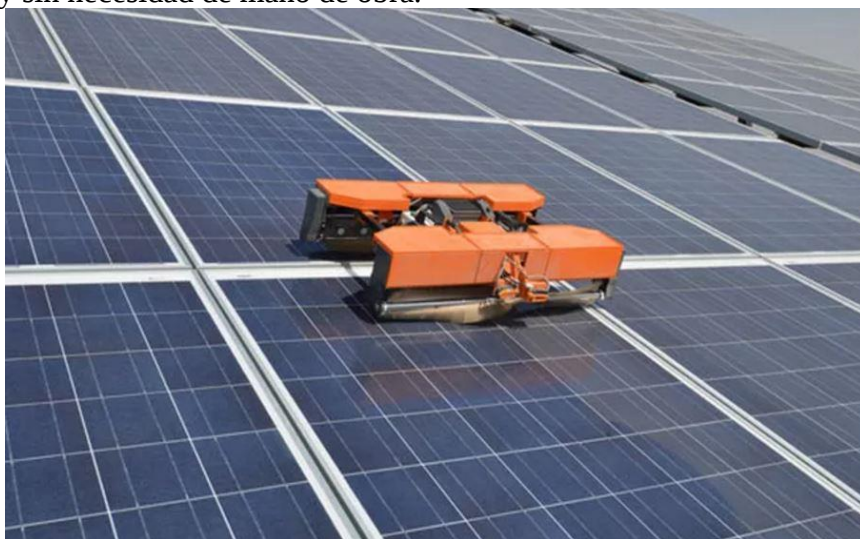
Ilustración 21: Limpieza de panel fotovoltaico mediante robot. Fuente: Google photos.
