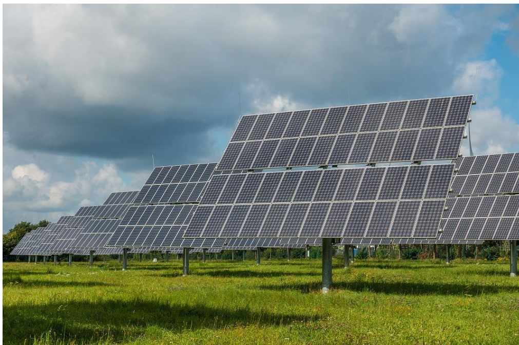
Ilustración 18: Impacto visual de la fotovoltaica terrestre. Fuente: Google potos.
