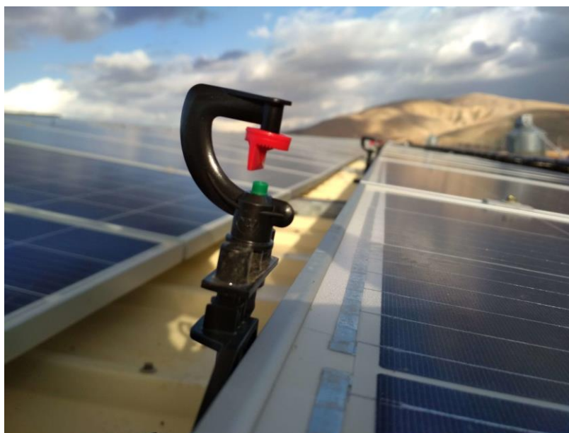
Ilustración 22: Limpieza de panel fotovoltaico mediante Spark. Fuente: NAANDANJAIN.
