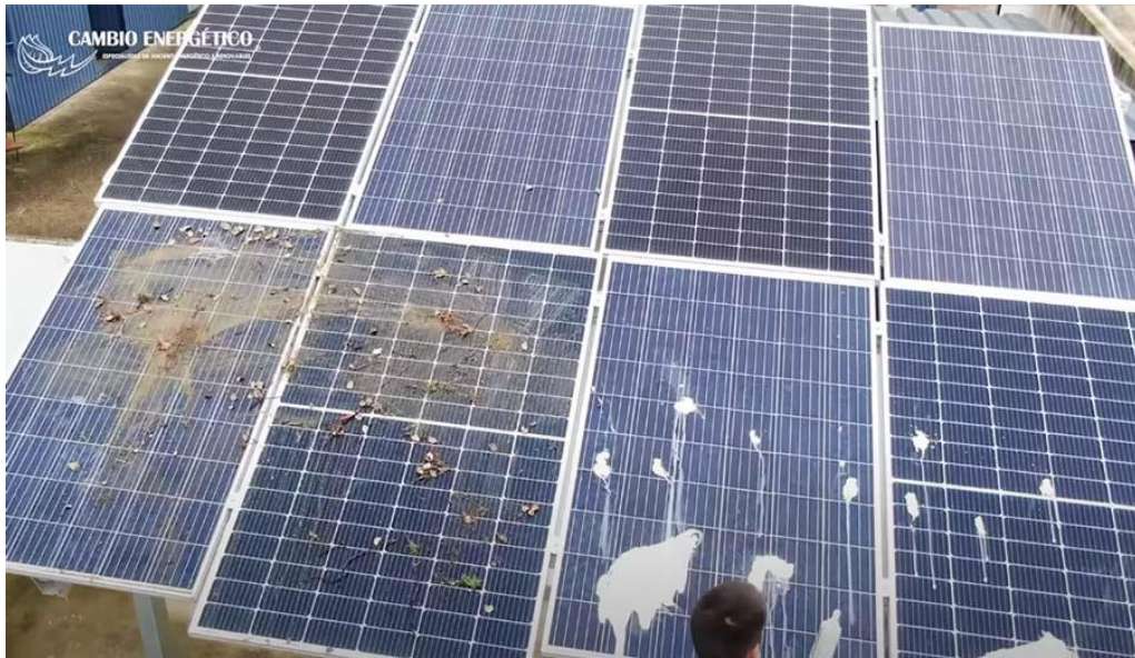
Ilustración 83: Deposiciones de aves sobre los generadores. Fuente: (Energético, 2021)
