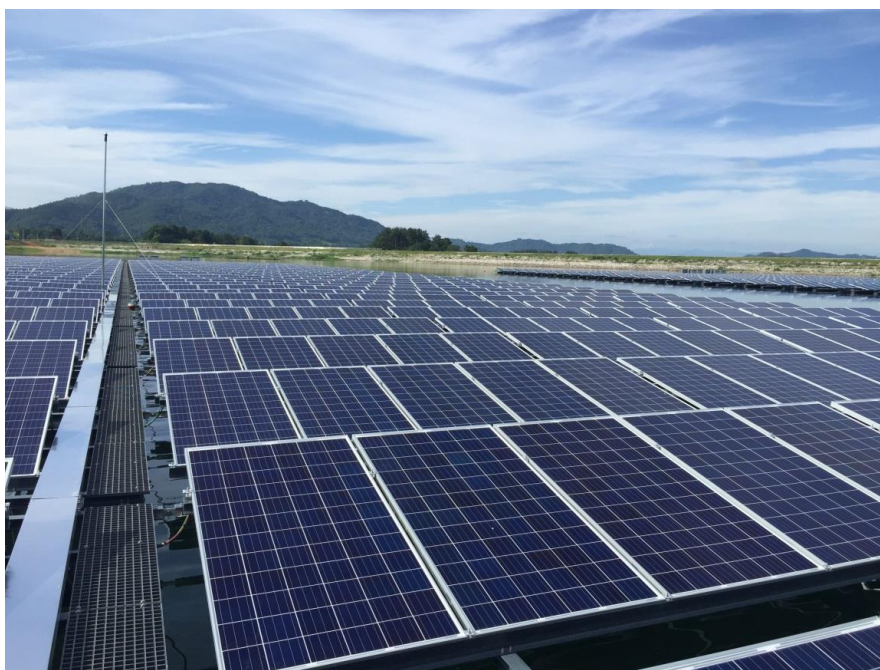
Ilustración 7: Parque fotovoltaico flotante de Jipyeong. Fuente: Google pots
