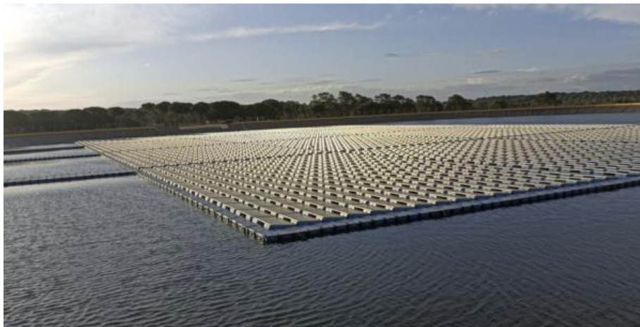
Ilustración 14: Planta fotovoltaica en el Embalse de las Yeguas (Huelva). Fuente: Google potos.
