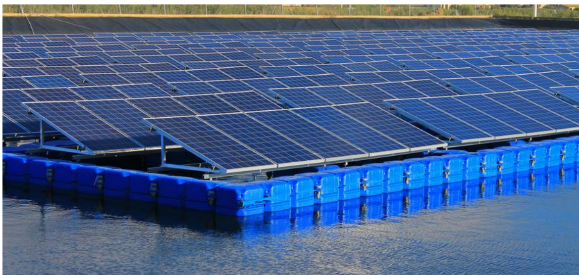
Ilustración 35: Primera instalación fotovoltaica flotante de España (Sistema de flotación SeaBlock). Fuente: Google photos.
