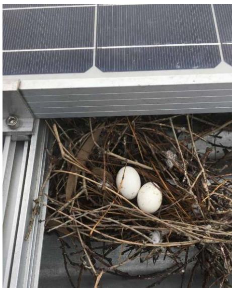
Ilustración 23: Nido en generador fotovoltaico. Fuente: Google photos.
