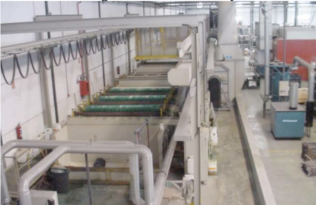
FIGURA 10: Fotografía de las instalaciones de cromado
