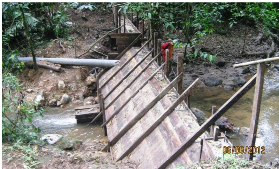
Ilustración 82: Represa y tubería de presión, microcentral de Jinotega. [147]
