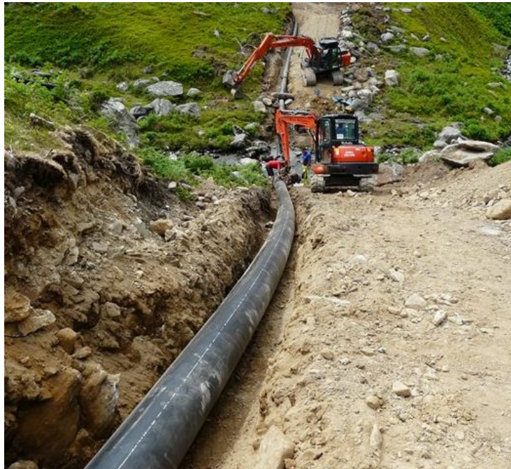
Ilustración 45: Tubería forzada de microcentral sobre zanja. [128]
