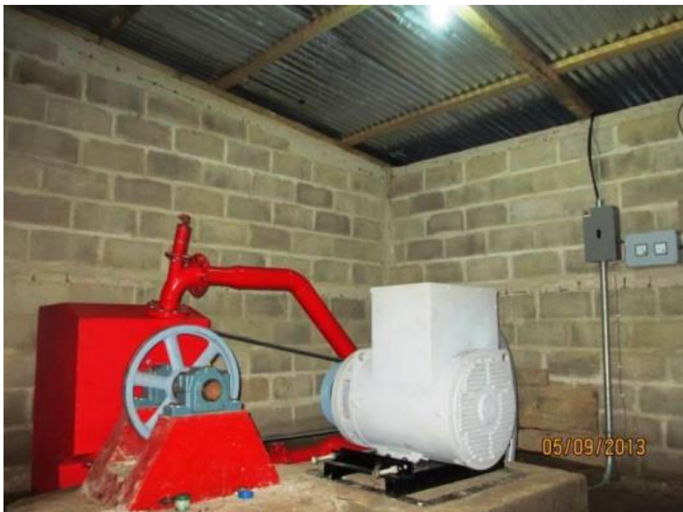
Ilustración 84: Equipo electromecánico, microcentral de Jinotega. [I 47 ]
