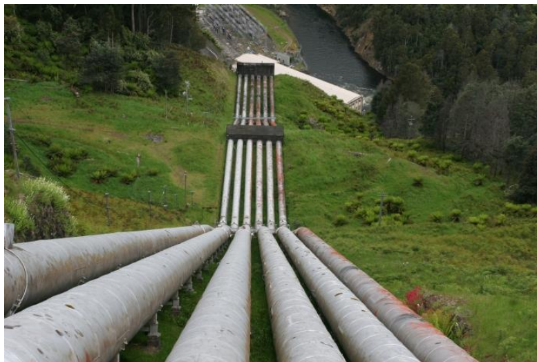
Ilustración 44: Tuberías forzadas en superficie. [127]
