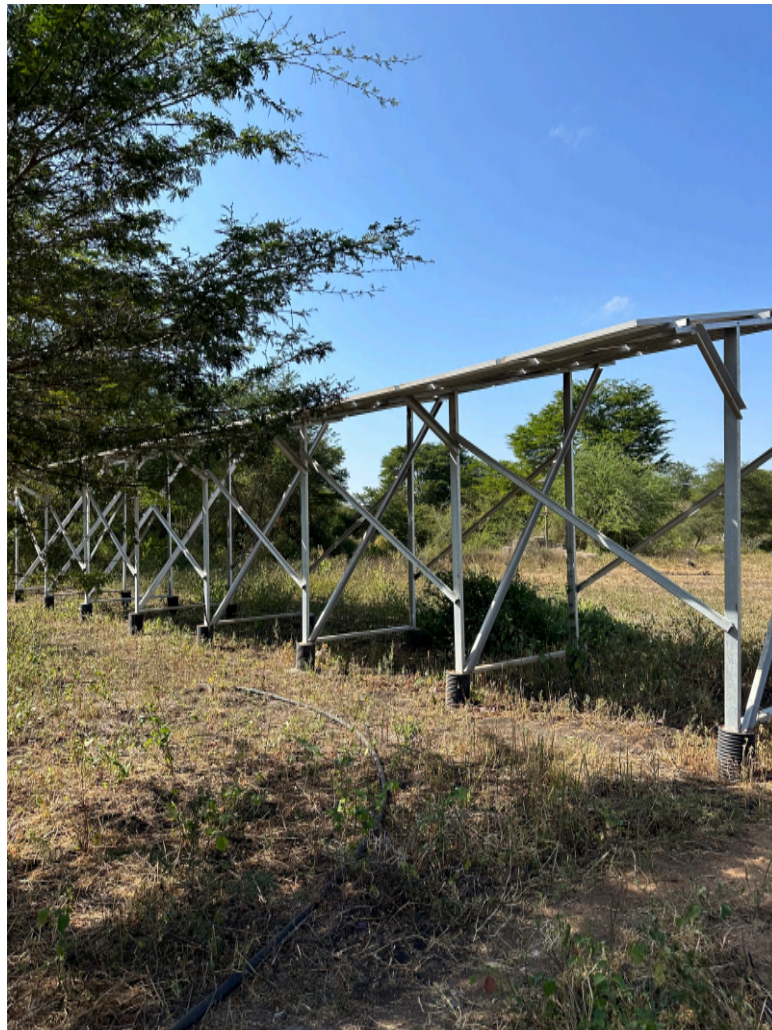
Ilustración 14. Paneles solares para energía de las bombas (Imagen de elaboración propia)
