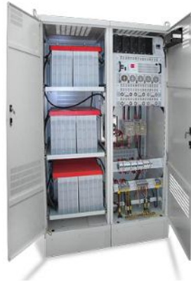
Figura 6. Rectificador alta frecuencia 110 & 125 & 220 Vcc
