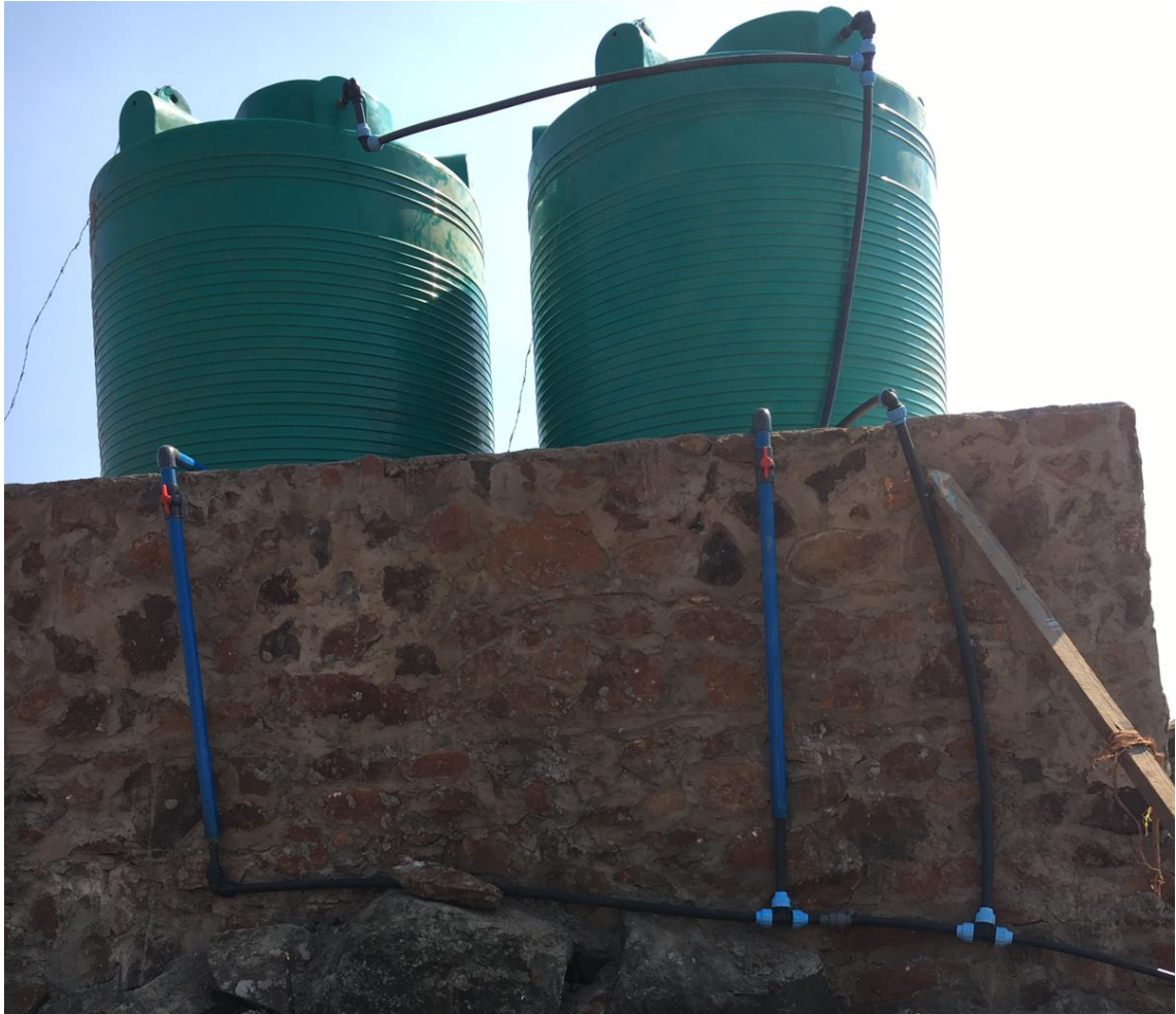
Ilustración 66: Conexión de las tuberías en los tanques de almacenamiento
