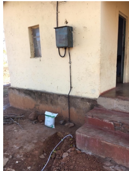
Ilustración 80: Cuadro eléctrico más cercano
