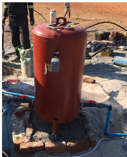
Ilustración 78: Tanque de presión
