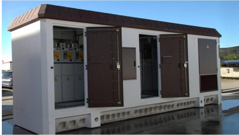
Ilustración 41: Centros de transformación de MT
