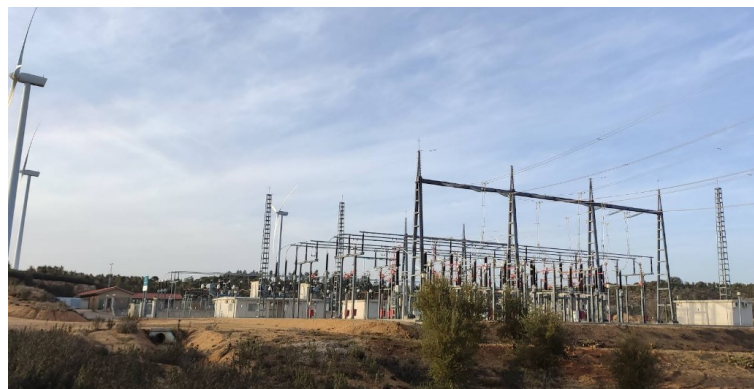
Figura 28: Subestación Santiz 220 kV, Google Maps.
