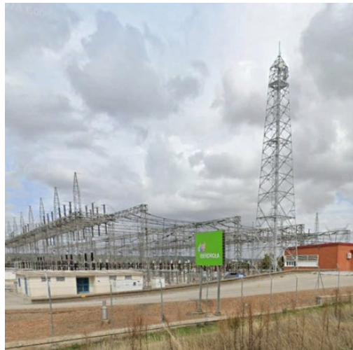
Figura 7: Subestación Villalbilla, Google Earth.
