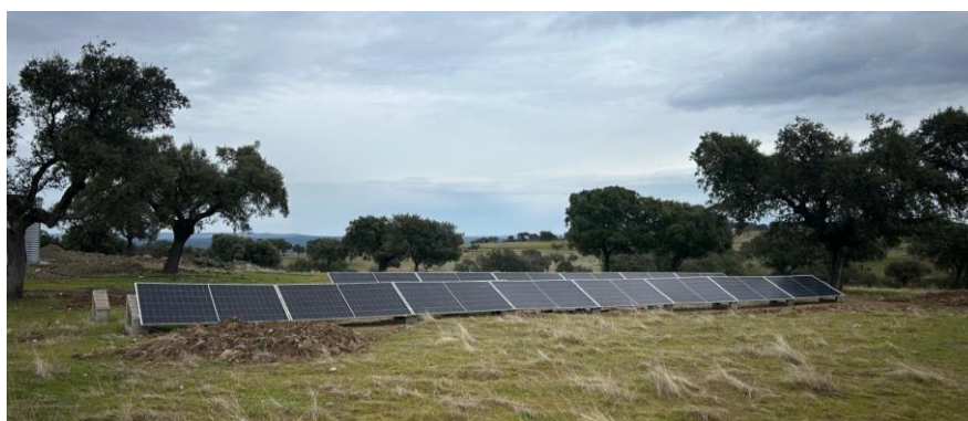
Figura 10 - Instalación fotovoltaica de Finca Pareja.
