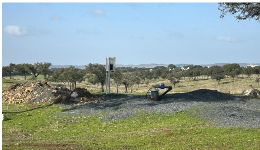
Figura 9 - Infraestructura hídrica de Finca Pareja: pozo y sistema de bombeo.
