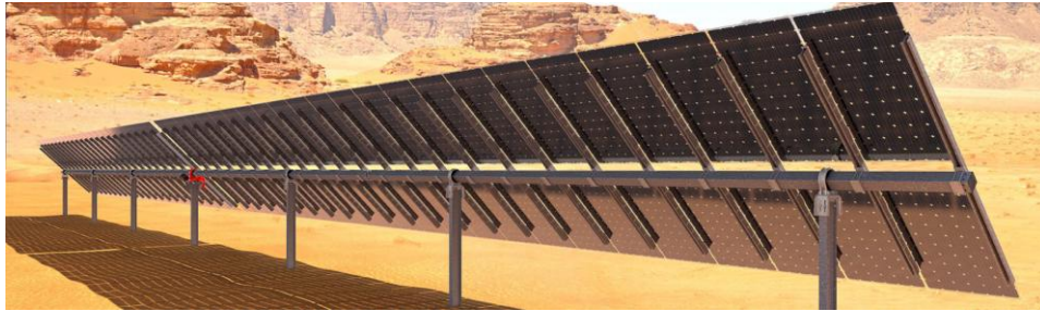
Figura 20 - Seguidor solar SF7
