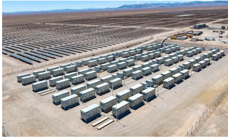
Ilustración 14: Planta de sistemas BESS en Chile [12].
