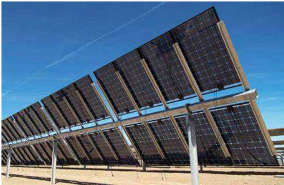
Ilustración 8: Imagen de paneles solares bifaciales
