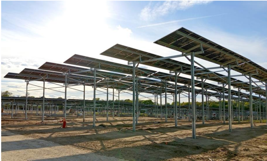
Figura 11: Estructura fija. Fuente: Ijes Solar.
