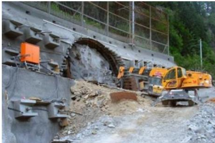
Figura 8. Comienzo de la obra de la galería superior en Nant de Drance (Suiza)
