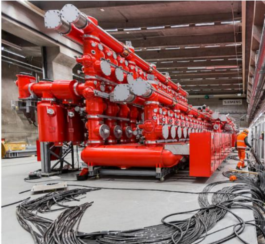
Figura 12. Subestación GIS Nant de Drance
