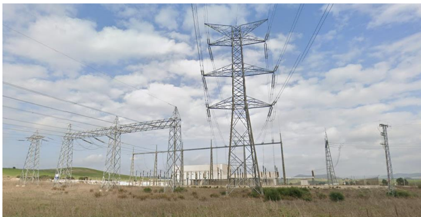
Figura 9: Vista de la Subestación Gazules desde Google Maps
