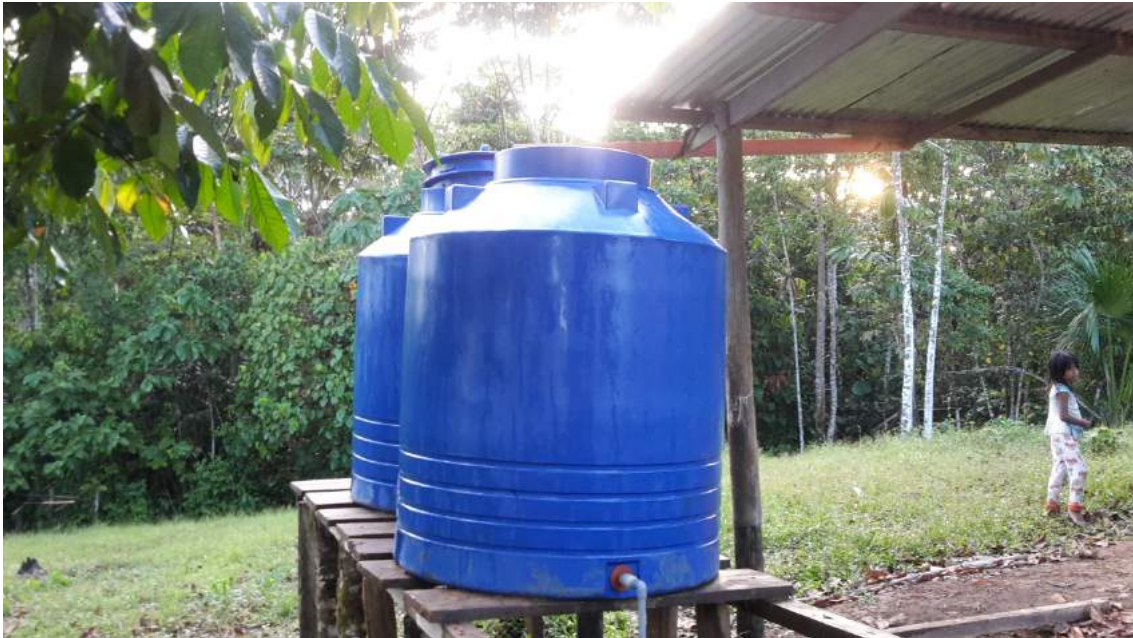
Ilustración 7 - Sistema de captación de agua de lluvia instalado en Villa Gonzalo
