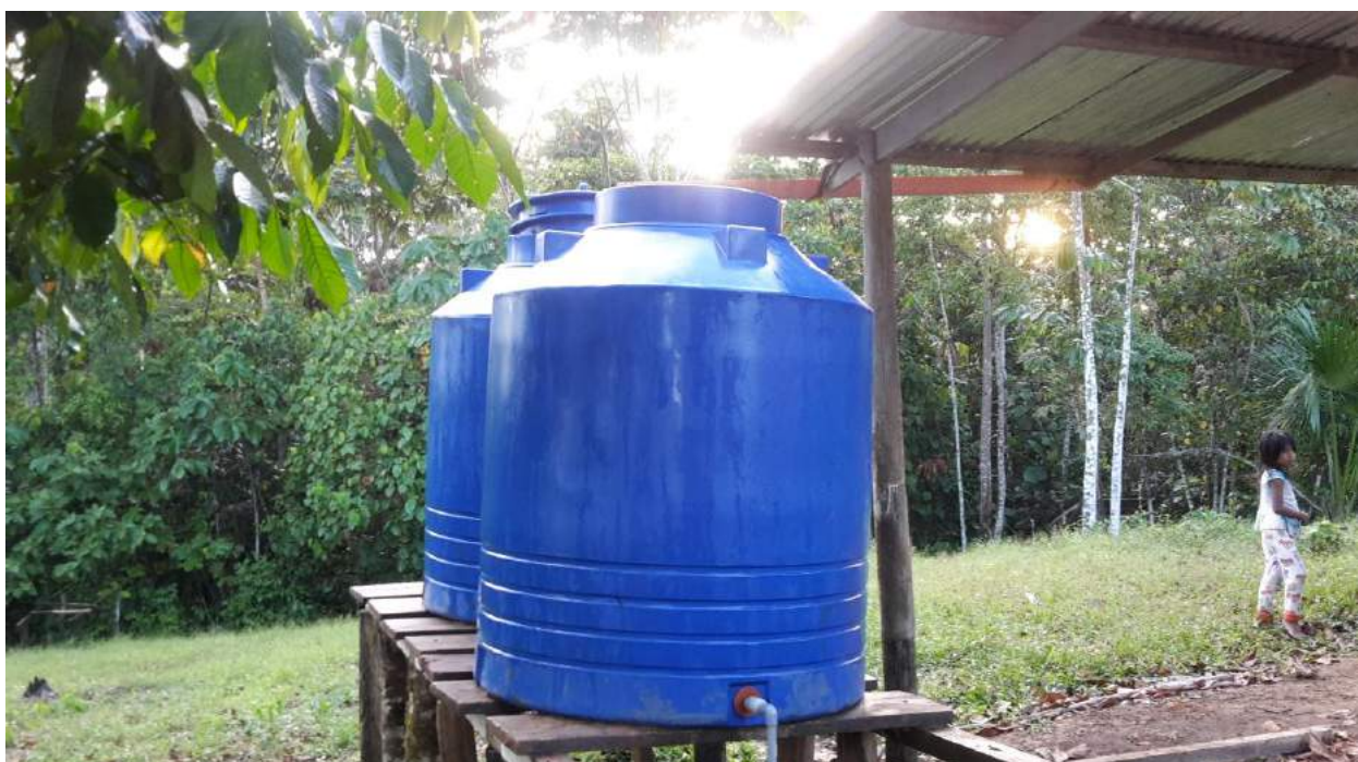
Ilustración 39 - Depósitos instalados en la comunidad.
