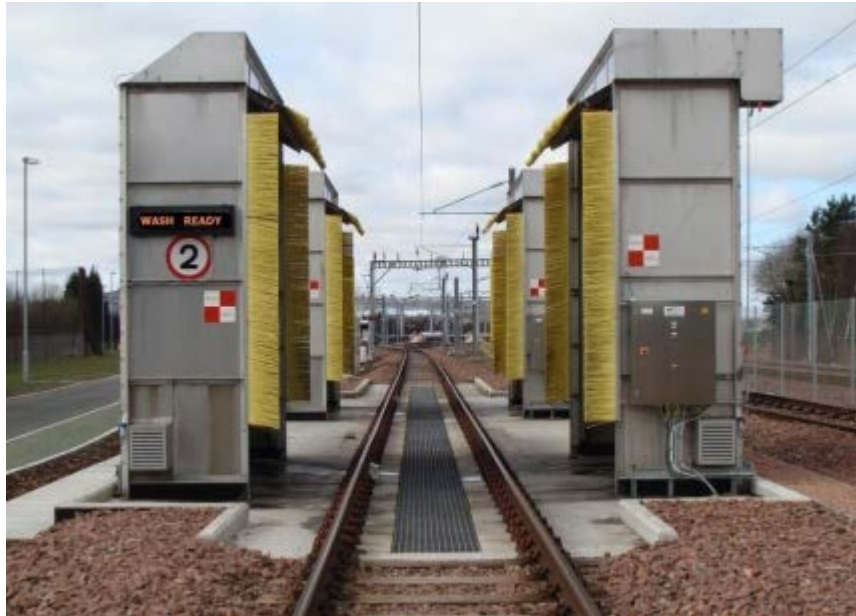
Figura 21: Túnel de Lavado al paso.
