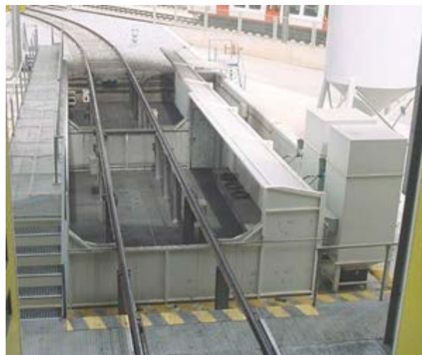
Figura 24: Cabina de Lavado y Soplado de Bajos.
