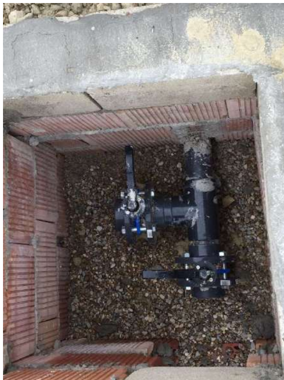
Ilustración 19- Válvula salida depósito
