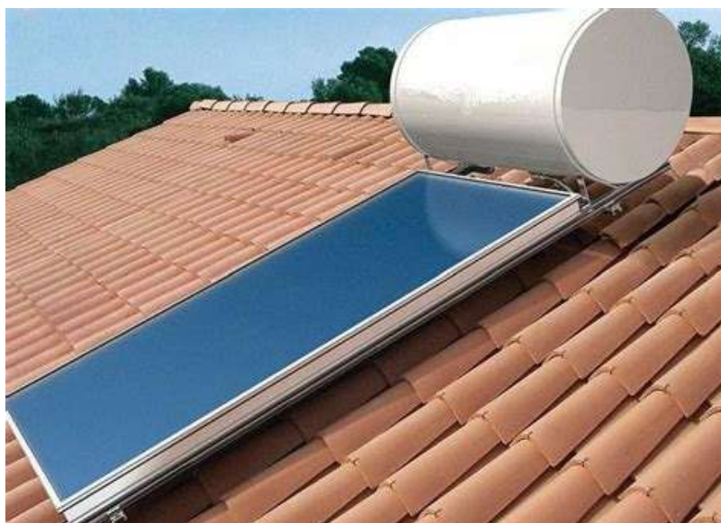
Ilustración 18: Panel solar térmico
