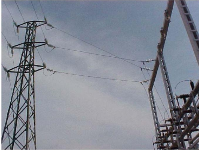
Figura 3. Línea eléctrica alimentando subestación [1]
