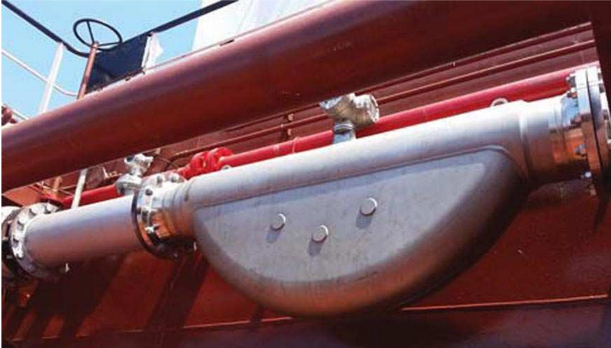
Sistema bunkering con contador másico
