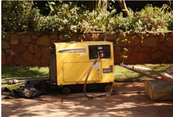
Ilustración 17 Generador utilizado por una lodge para el abastecimiento eléctrico
