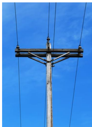
Ilustración 17. Poste de madera
