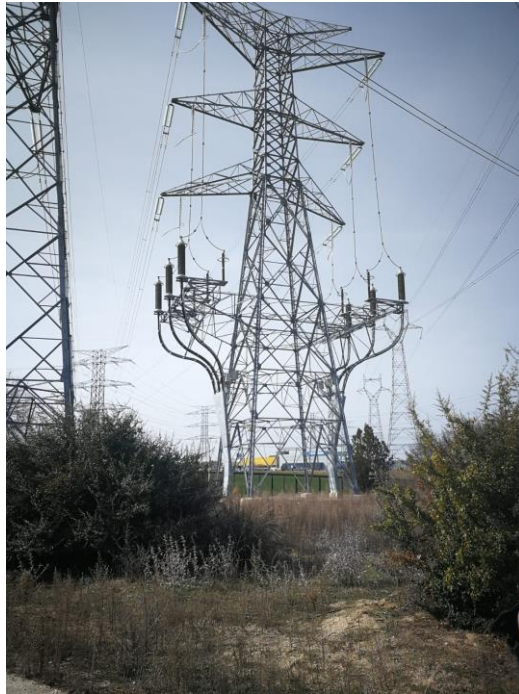
Ilustración 10. Apoyo fin de línea
