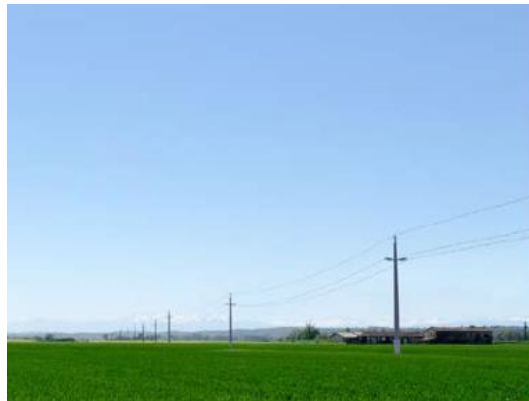
Ilustración 19. Línea de apoyos de fibra de vidrio
