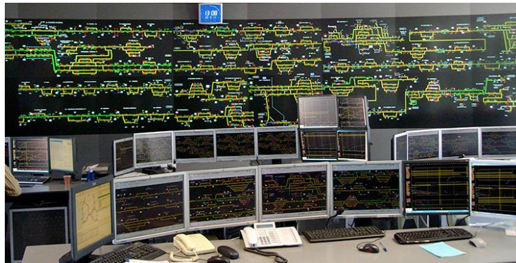
Figura 2. Ejemplo de centro de control. Fuente: CAF
