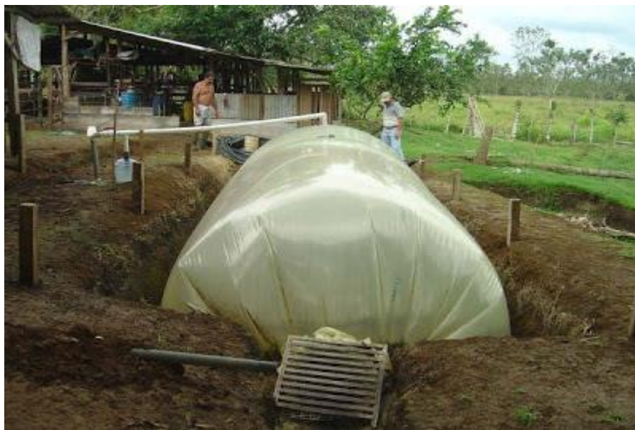
Ilustración 15. Biodigestor de estructura flexible empleado en una zona rural. Fuente: Google images
