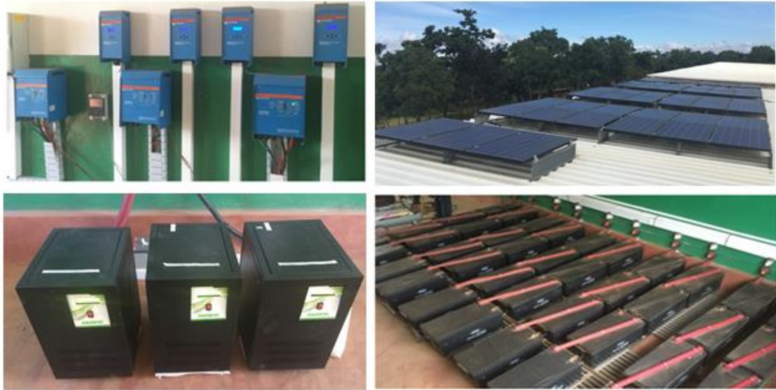
Ilustración 20. Elementos del sistema solar FV. Arriba izq: reguladores de carga; arriba drch: paneles solares FV; debajo izq: inversores; debajo drch: baterías. Fuente: elaboración propia
