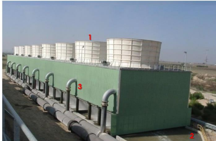
Figure 9- Cooling tower, Source [Curso Introducción de Técnicas Reunidas]
