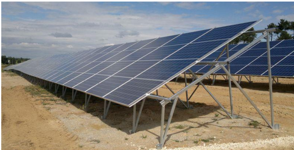
Ilustración 31: Estructura suelo de la instalación. Fuente: Autosolar
