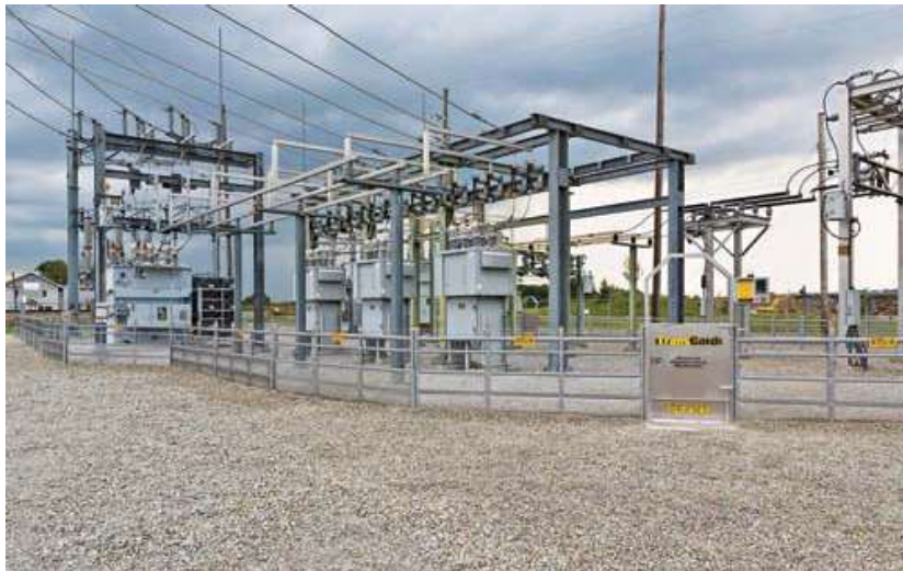
Ilustración 40: Subestación con valla electrificada de protección contra animales. Fuente: Utility products
