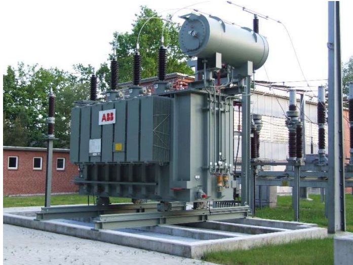
Ilustración 21: Transformador de potencia. Fuente: ABB
