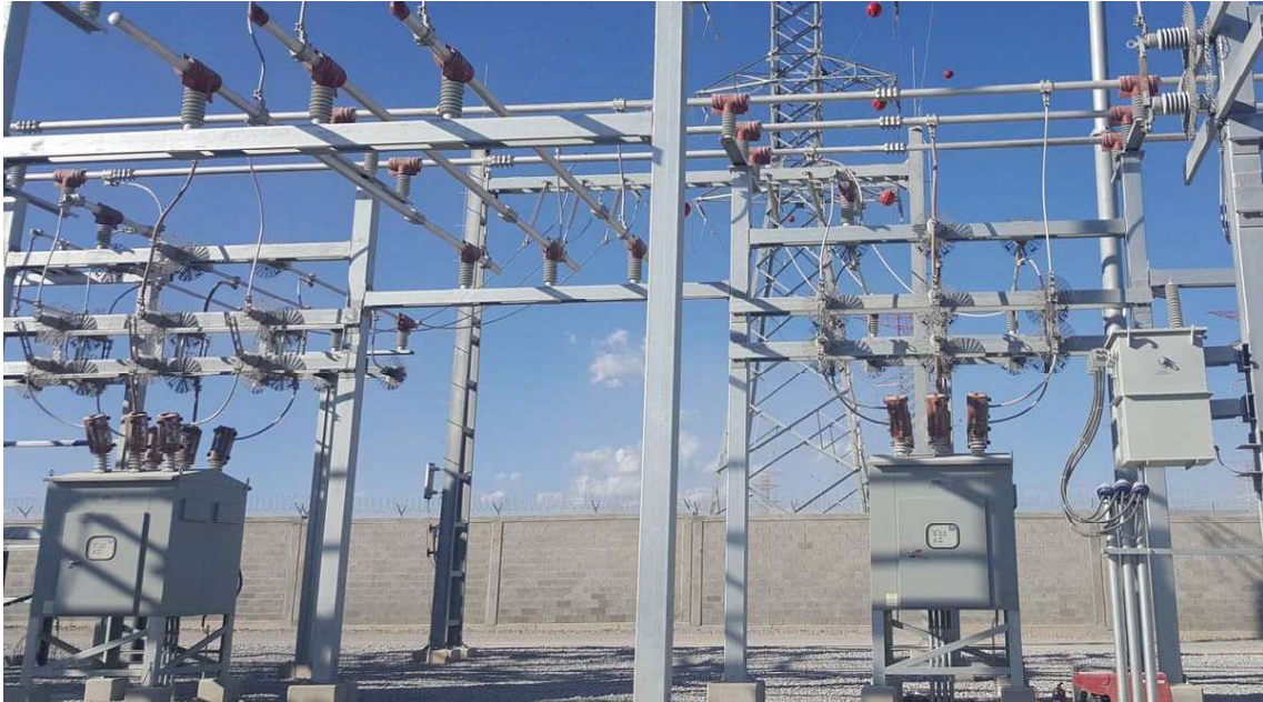
Ilustración 29: Interruptor "dog house". Fuente Ingeniería de proyectos
