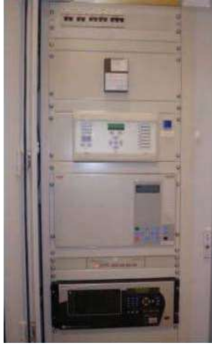
Ilustración 36: Armario de control y protección. Fuente: Bibing
