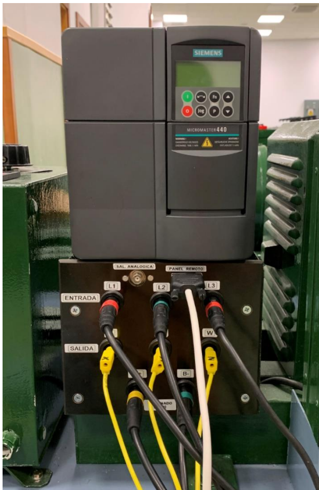
Figura 20: siemens micromaster + conexiones
