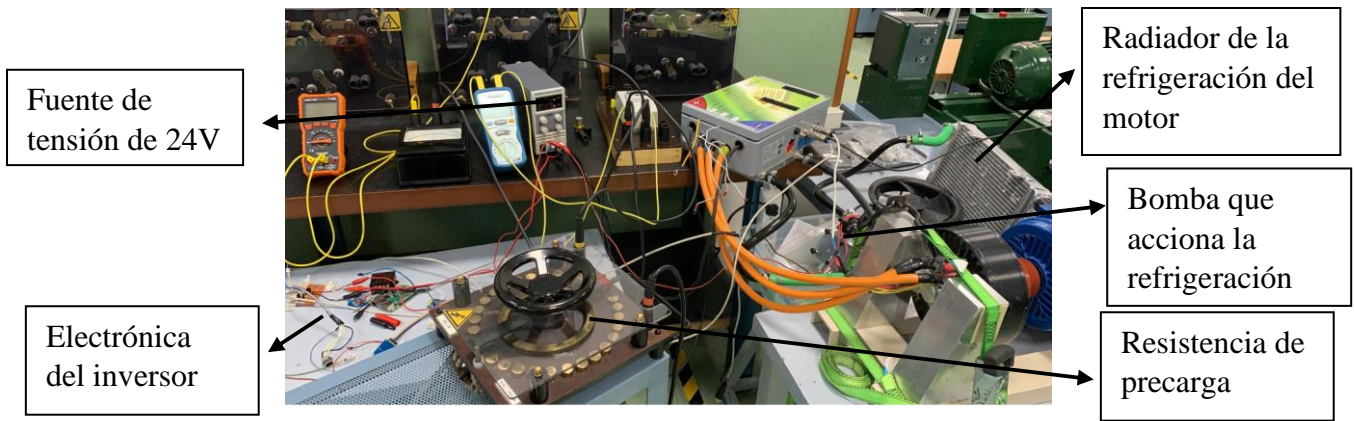
Figura 19: disposición de inversor, resistencia de precarga, electrónica de alimentación del inversor, refrigeración y fuente de continua de 24V
