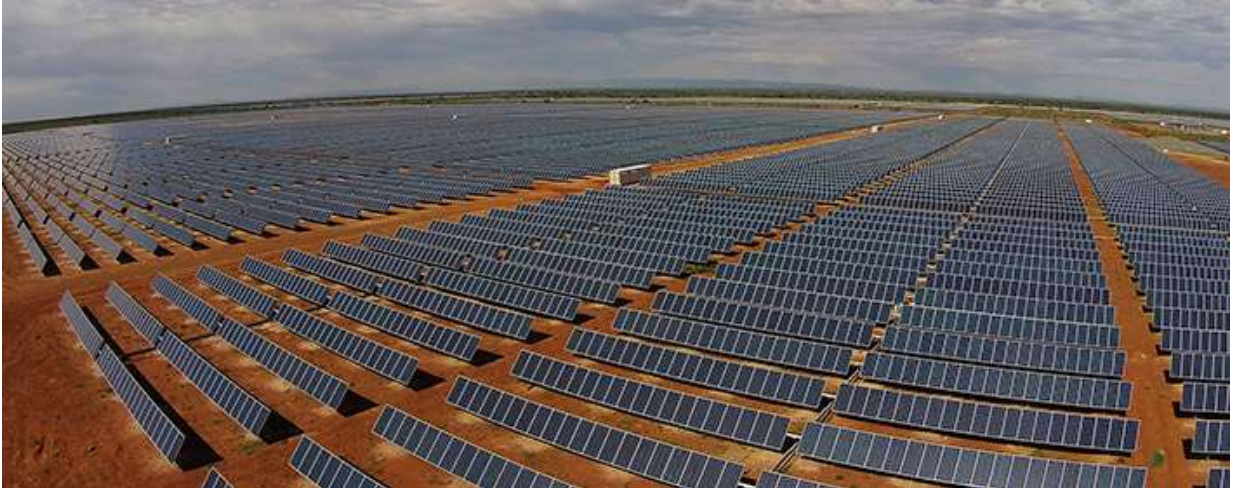
Figura 19: Planta Fotovoltaica del Romero Solar (Fuente: Diario Renovables)
