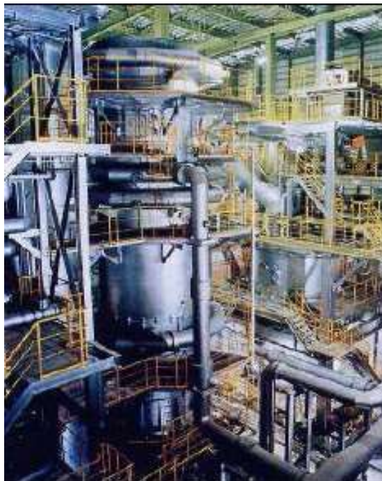
Figura 10: Instalación de Gasificación por Plasma de la Planta de Utashinai (Fuente: Westing House Plasma)
