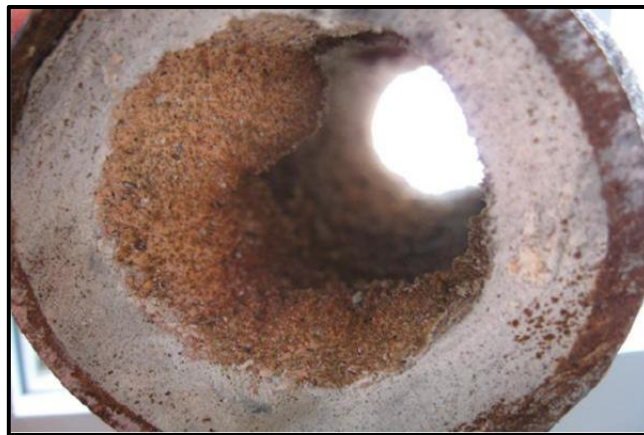
Figura 3. Corte transversal de tubería metálica con presencia de materia orgánica, biopelículas y corrosión, factores que favorecen la colonización de la bacteria (Orsi et al., 2014)
