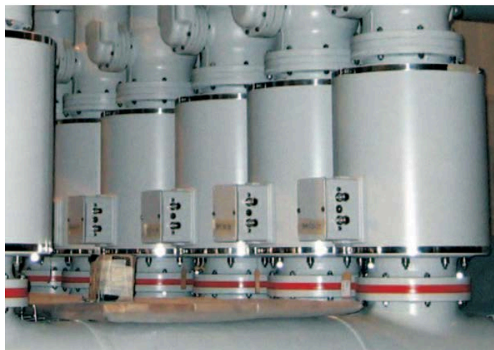
Fig. 7: Transformadores de corriente de una subestación GIS
