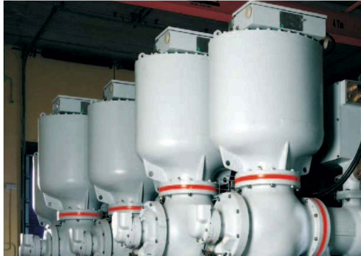
Fig. 6: Transformadores de tensión de una subestación GIS
