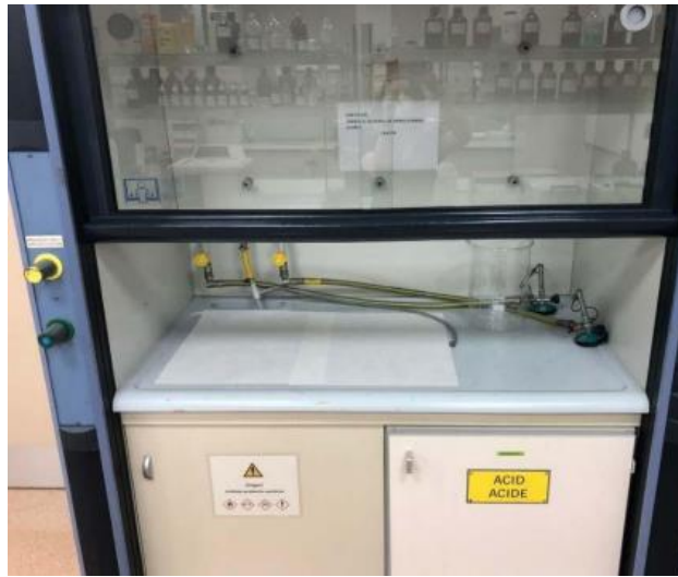
Figura 10: Campana de extracción [ESPI21]
