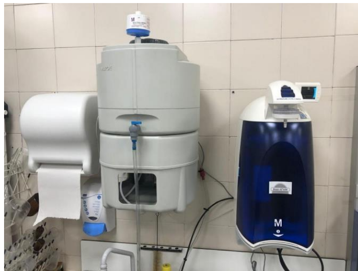
Figura 8: Equipo de purificación de agua [ESPI21]
