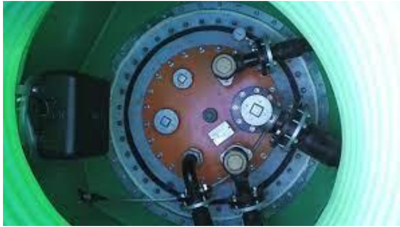
Ilustración 10- Vista orientativa sobre la boca de hombre y sus tubuladuras ( https://www.luisurbina.com )
