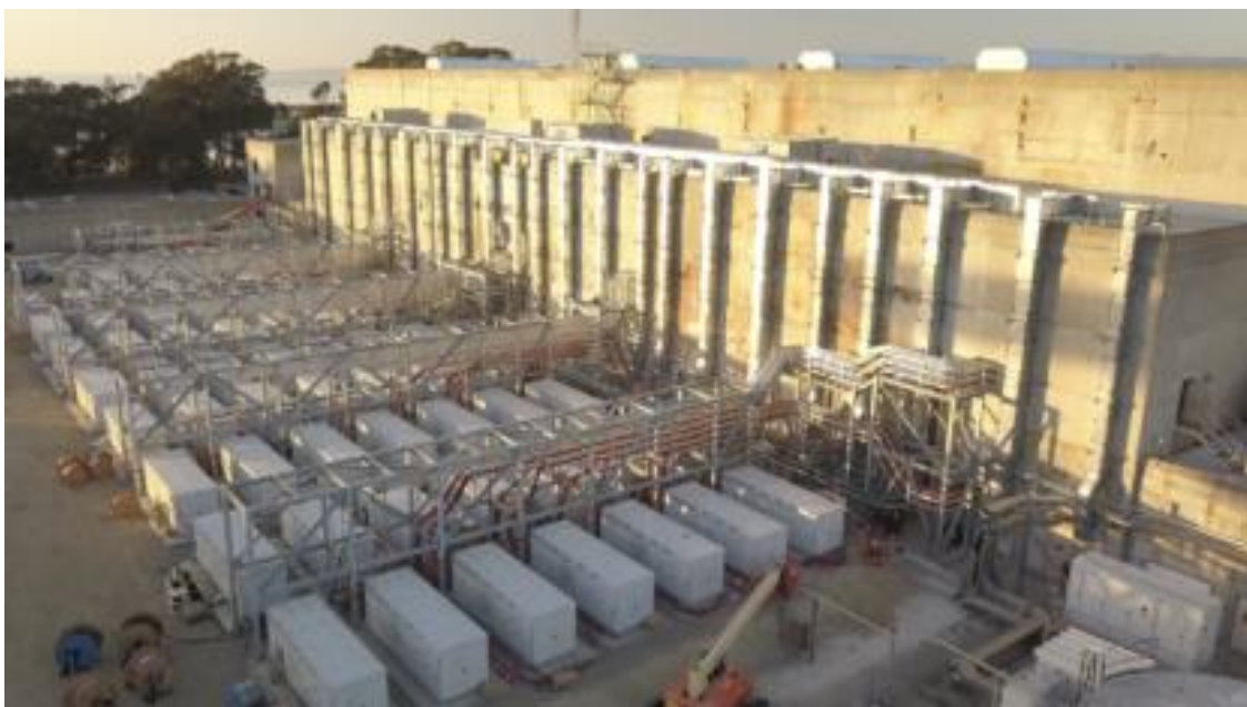
Ilustración 2.13: Planta de almacenamiento de energía por baterías Moss Landing
