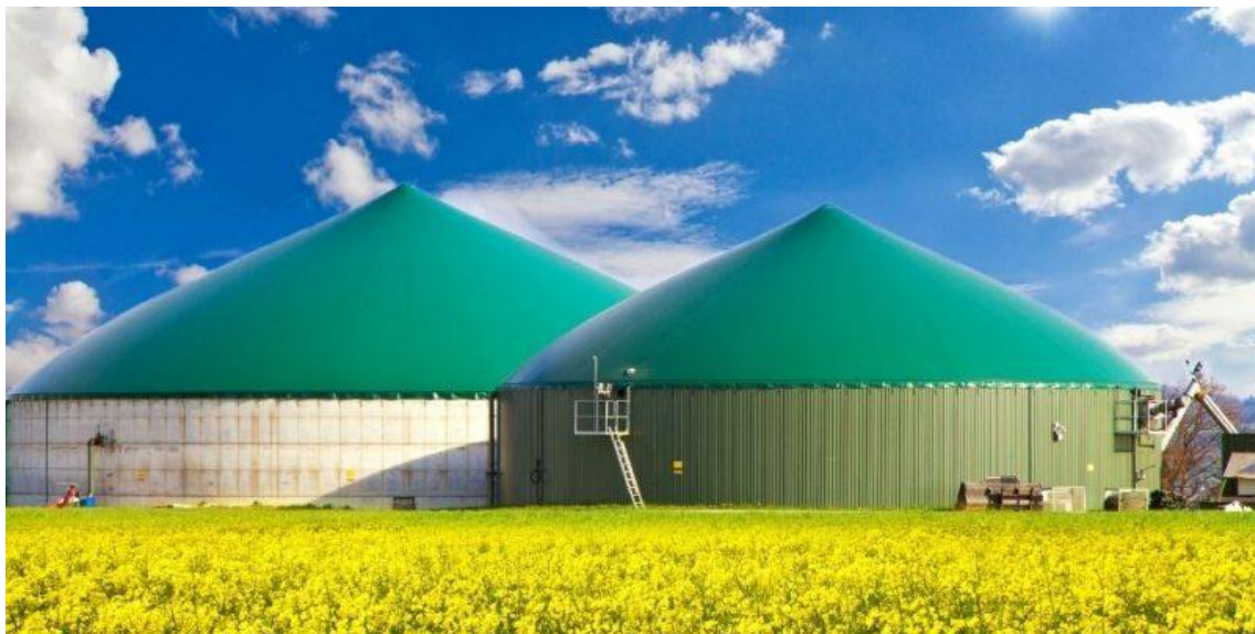
Figura 14. Digestor de mezcla completa de cubierta cónica. Fuente: (Genia Bioenergy, 2021)
