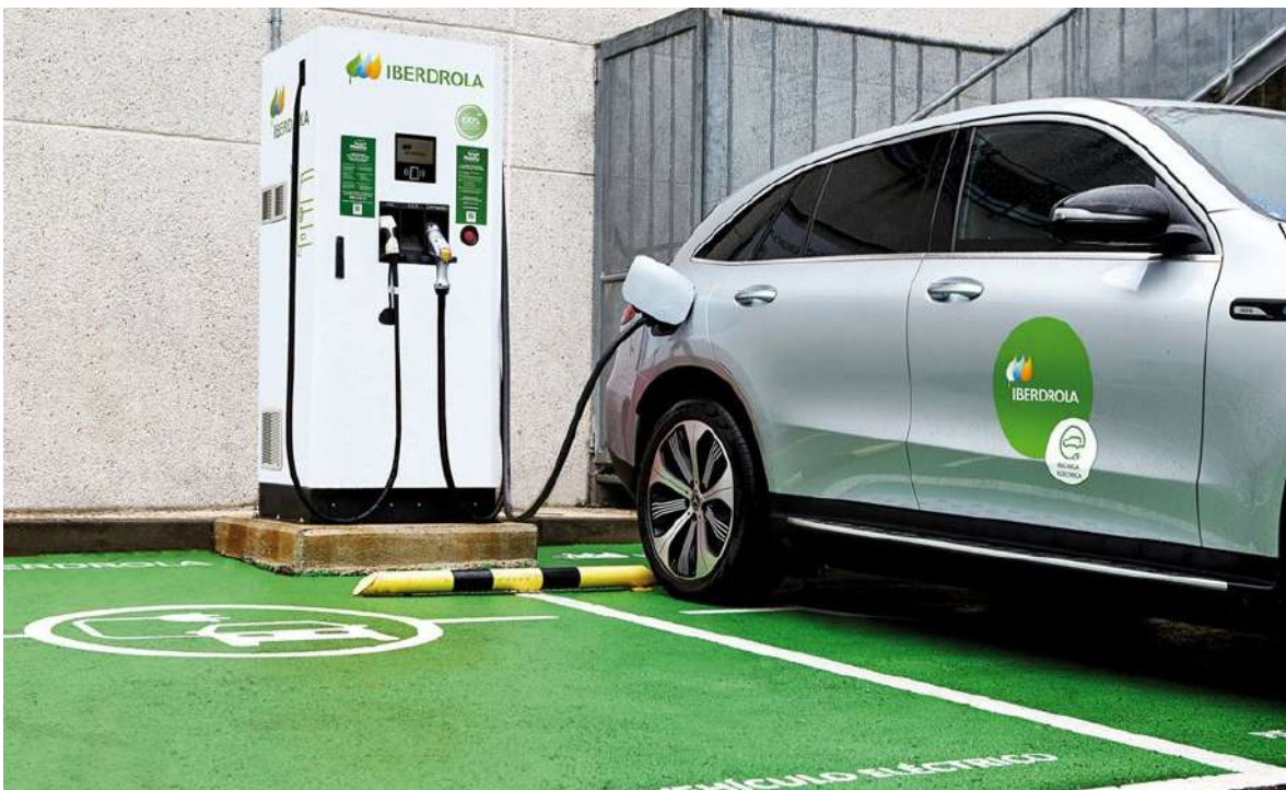
Figura 15: Cargador para vehículos eléctricos (Fuente: Iberdrola)
