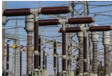
Figura 8: Interruptor instalado en una subestación (Fuente: Todo Luz y Gas)
