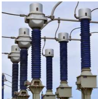
Figura 10: Transformador de tensión (Fuente: Artech)
