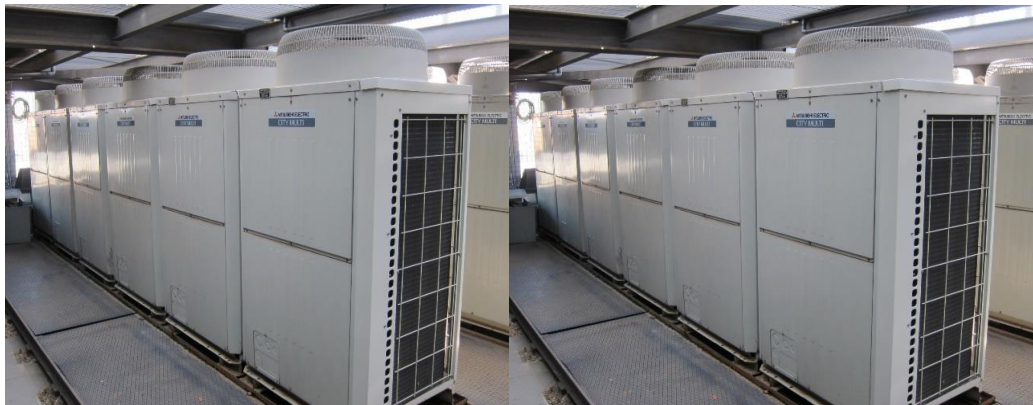
Figura 2 y 3: Equipos del sistema de climatización. Fuente Welltech Sustainability Solutions
