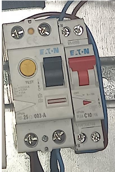
Figura 22: Protecciones eléctricas instaladas. (Elaboración propia)
