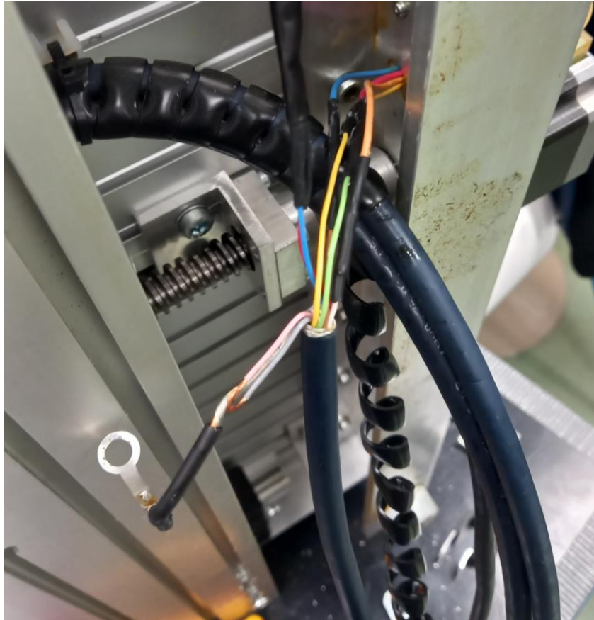
Figura 8: Detalle del cableado. (Elaboración propia)
