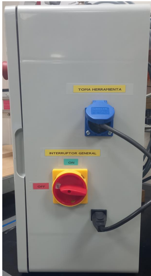
Figura 45: Panel lateral derecho del controlador. (Elaboración propia)
