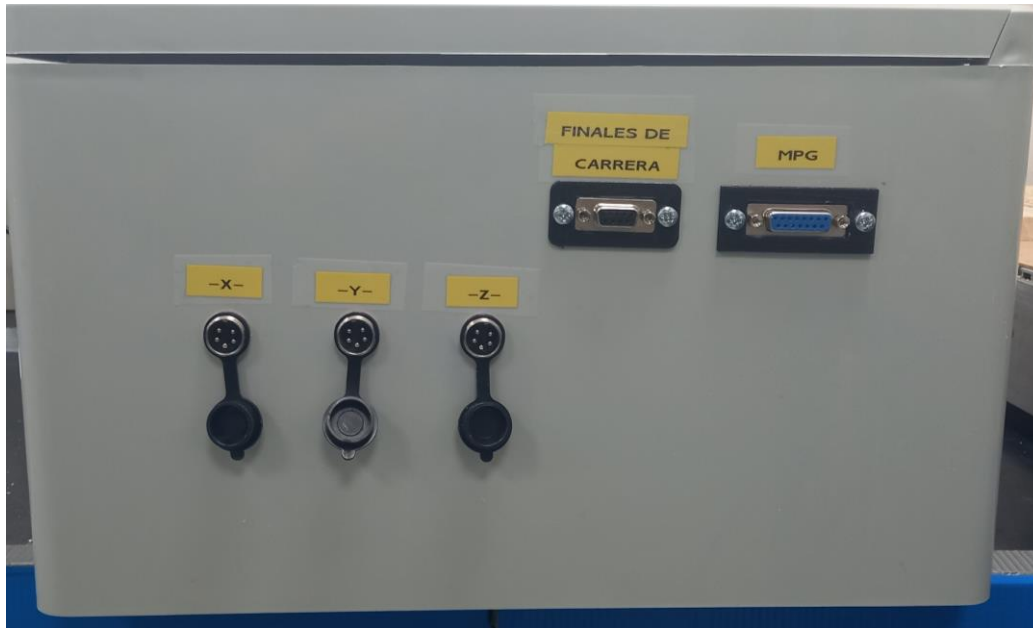
Figura 44: Panel superior del controlador. (Elaboración propia)
