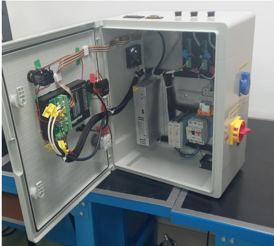
Figura 46: Controlador con la puerta abierta. (Elaboración propia)
