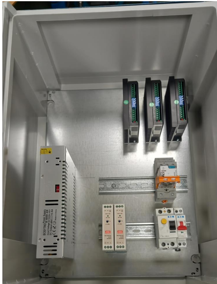
Figura 29: Elementos montados sobre la placa galvanizada en el interior del armario eléctrico. (Elaboración propia)
