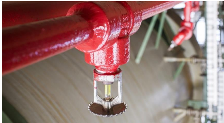
Ilustración 2: Rociador o Sprinkler.
